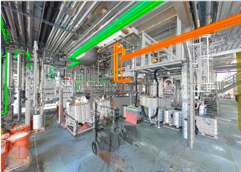
Fassabfüllung mit Vorlage. Ausbau einer chemischen Bestandsanlage. Oben: Erweiterungsmodell (Planungsphase 2 - color) ergänzend zum Bestandsmodell (Planungsphase 1 - mono) der Produktionsanlage. Unten: Erweiterungsmodell (Planungsphase 2 - color) ergänzend zum Bestandsmodell (Planungsphase 1 - mono) einer Produktionsanlage, überlagert mit 3D-Scandatei.
