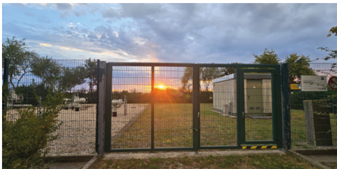
Bild 2: Klassische Absperrstation mit Armaturengruppe auf der Pipeline JAGAL
