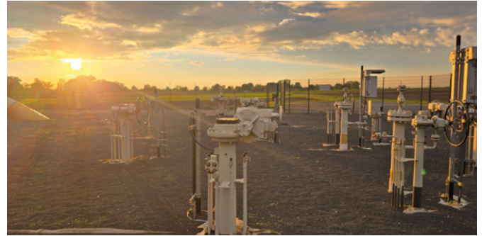
Bild 3: Absper- und Molchstation auf der Pipeline NOWAL im Norden Deutschlands
